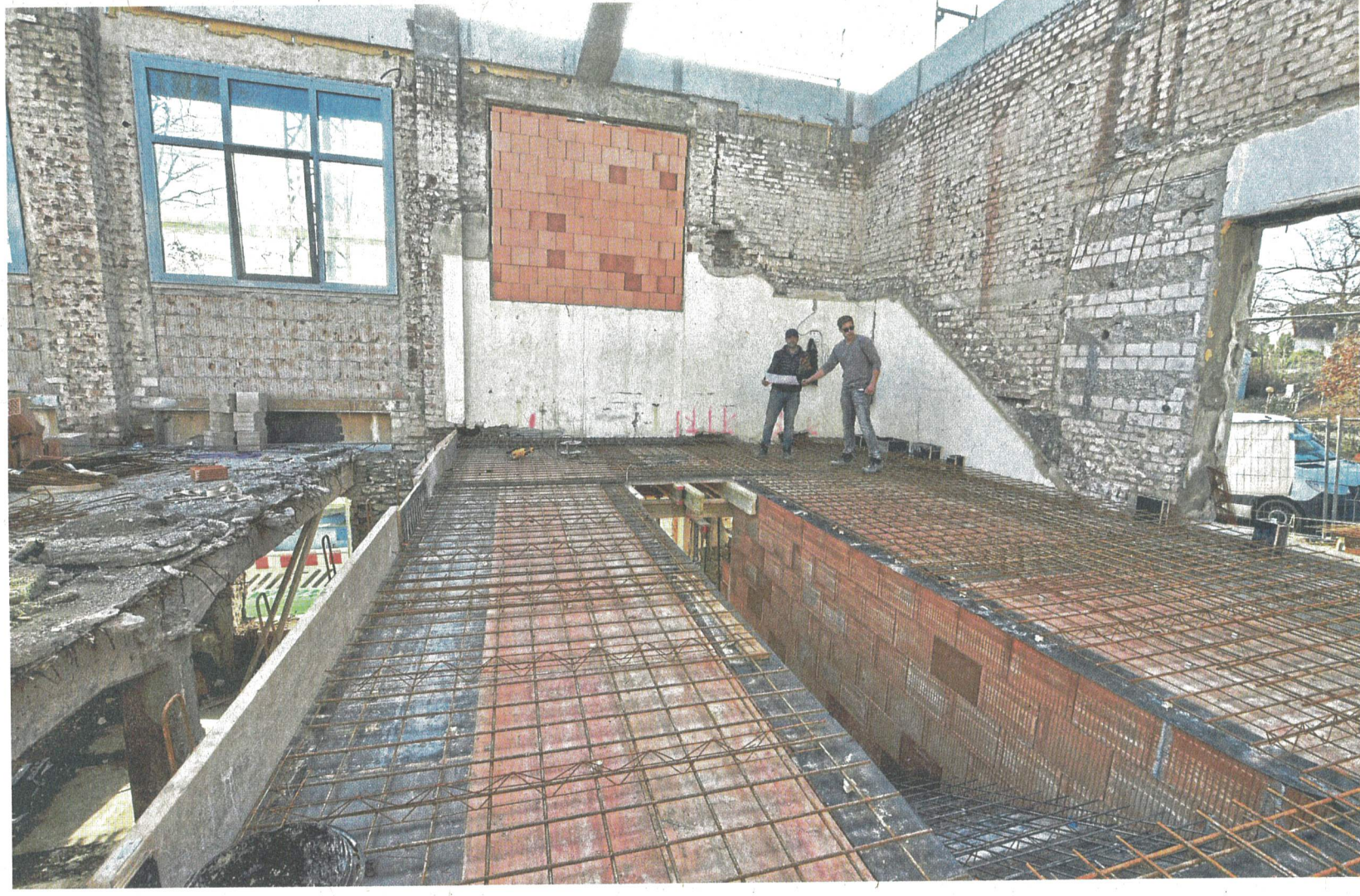
Eine wichtige Investition der Verbandsgemeinde Betzdorf-Gebhardshain ist die Sanierung der Schulturnhalle in der Schützenstraße, die mit rund 2,4 Millionen Euro veranschlagt ist.
